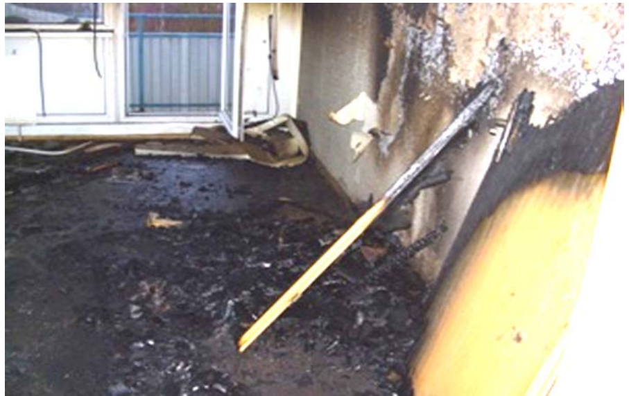
Brand leerstehender Wohnungen in der Eulerstr.
